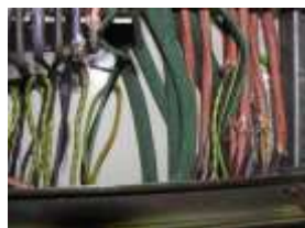
Gaine de câbles électriques
