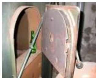
Tresse sur porte de chaudière
