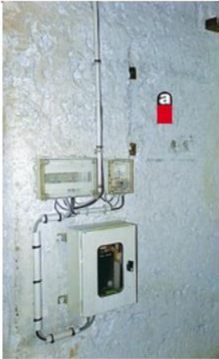
Intervention sur ou à proximité d'un boîtier électrique fixé sur une cloison recouverte d'un enduit amiante, (idem si bloc d'éclairage posé sur un flocage)
