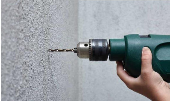
Perçement d'un mur avec un enduit du plâtre ou une peinture amiantée
